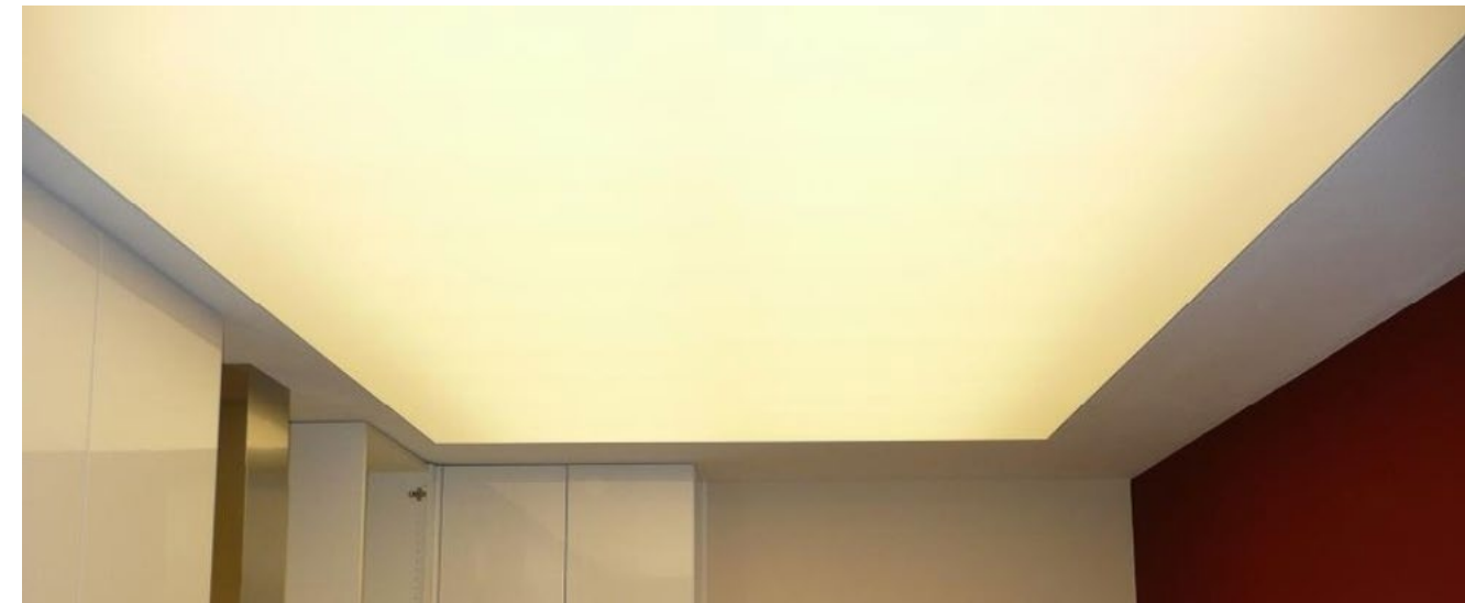
v chodbě: napínaný stropní podhled translucentní
